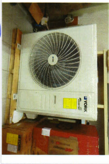
F5: AIRE ACONDICIONADO
