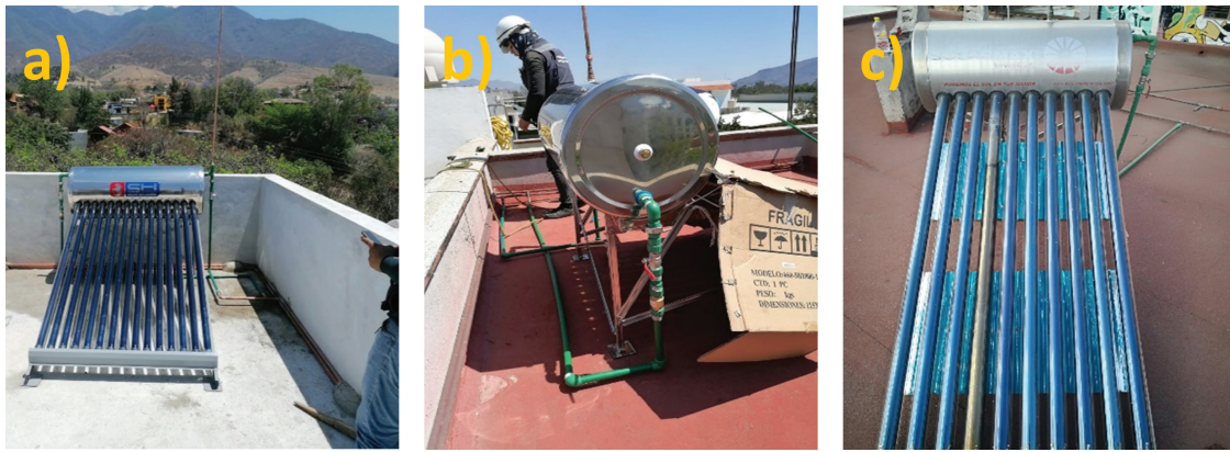
Figura 8. Calentador solar instalado sin válvulas anti-quemaduras: a) Tlacolula de Matamoros, b) San Antonio de la Cal y c) Cd. de Oaxaca de Juárez.
