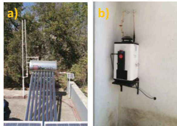
Figura 9. Instalación incorrecta de by pass. a) y b) Villa de Zachila. Fuente: Elaboración propia.
