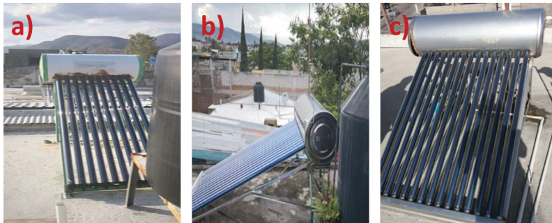
Figura 7. Calentador solar instalado sin elevar el tinaco en una altura óptima: a) Tlacolula de Matamoros, b) Santa Cruz Xoxocotlán y c) Cd. de Oaxaca de Juárez.
