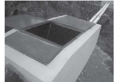
Figura 1. Sistema de rejillas PTAR-UTM Página 54.
